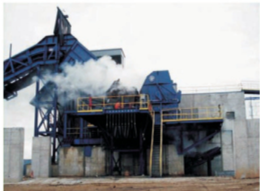
▲ 智能喷水系统 Smart water injection system
