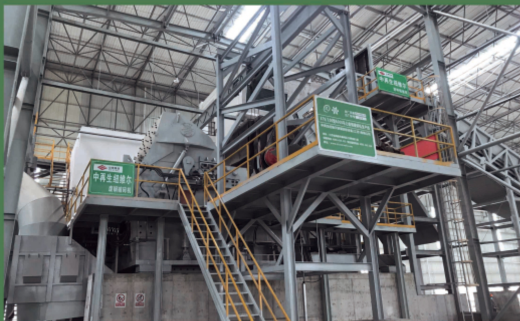
济钢集团纽维尔6000HP废钢破碎线，每小时产能达到150吨—200吨，年废钢加工能力高达40万吨。
